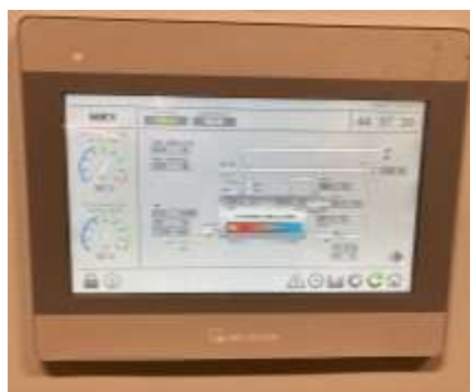
Obr. 5 - Obrazovka řídicího rozvaděče kotle K1.
