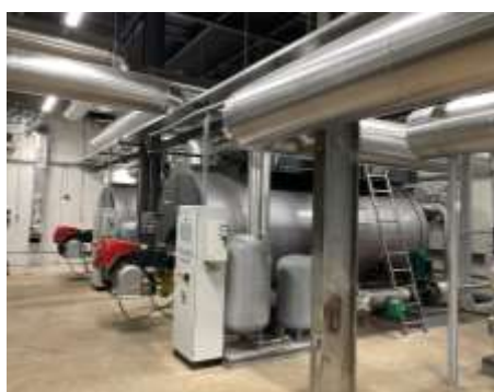
Obr. 4 – Náhled na kotle K1 a K2.
